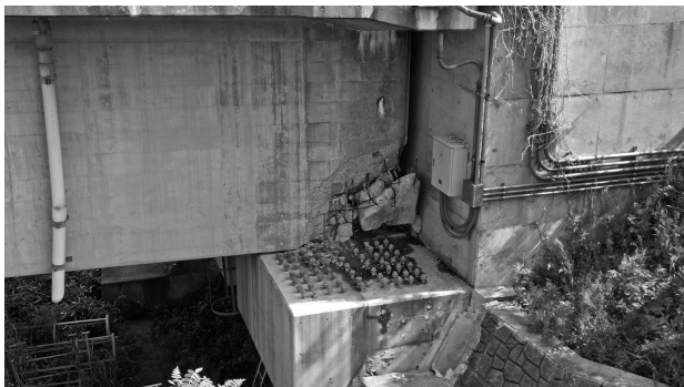
写真-4 島側橋台支承部の損傷
