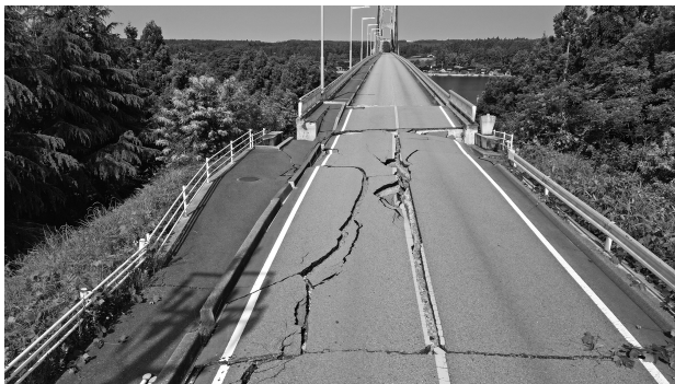
写真-3 農道橋アプローチ部の沈下 (島側)
