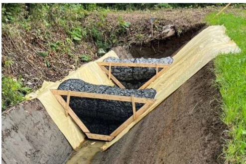
写真-4 濁水処理施設（幌延地区）
