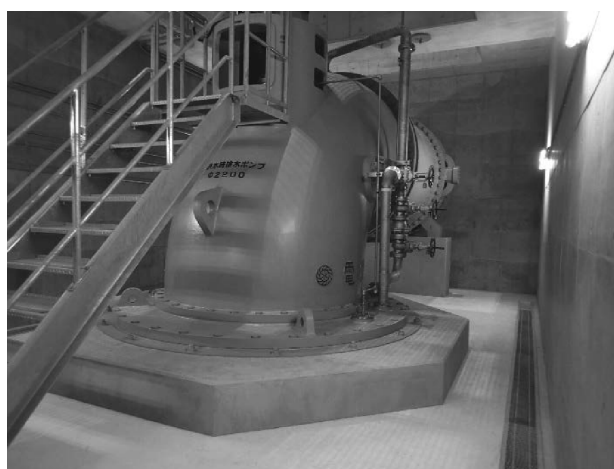
写真-3 排水ポンプ（洪水時排水ポンプφ2,200）
