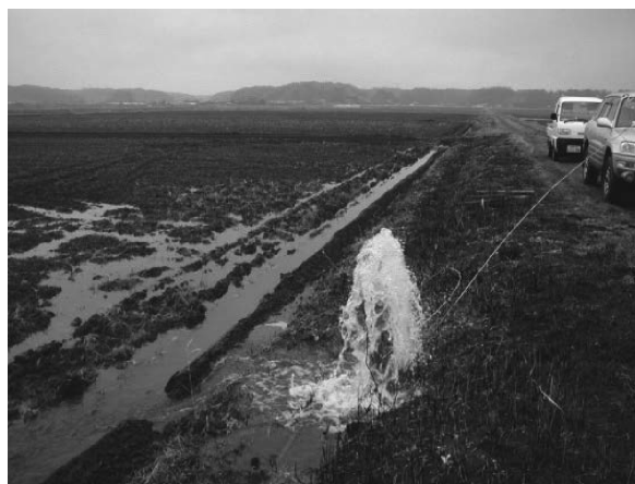
写真-1 老朽化したパイプラインの漏水
