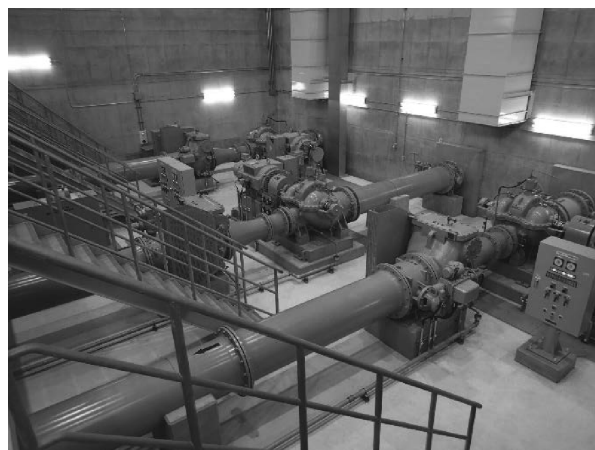
写真-2 揚水ポンプ
