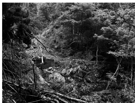
写真-6 損壊した大楠用水
