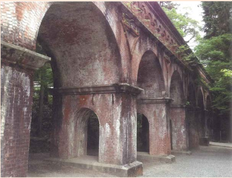
第 86 卷第 7 号（2018 年）表紙（藤原正幸氏撮影） 支線用水路（南禅寺水路閣・京都市）
