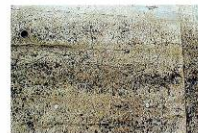
1. 水路壁面のひび割れ状況 (羽間開水路)
