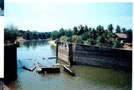
3. コルマタージュのゲート破壊状況(1994年3月撮影) (ポルトガル時代に遺棄されたと推測される)
