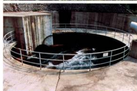
早月川発電所のヘッドタンク（内径10mのアーチ状の上部を水流できるように改造したもの）
