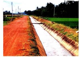
三次水路(マレーシア、ムダ地区) 農畜とセメントで建設される管溝の材料としてラテライトが利用される。三次水路の敷設は、用水改良とともに交通網の向上においても高く評価される。
