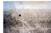
2. 水路壁面のひび割れ状況 (羽間開水路)
