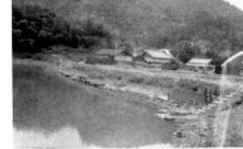
堤体前面が水牛渡り浸食により堤体断面が不足。 (静岡県土岐市地区)
