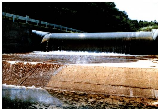
ゴム引布製起伏堰の (撮影時の) 写真。堰幅12.00m、堰高2.20m
