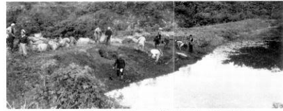
堤防の老朽化により堤体が崩壊したため、緊急工事を実施中（西宮市狭山地区）
