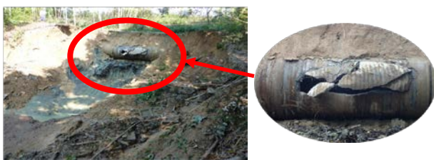
写真-2 高瀬支線漏水事故（H29.10 発生）
