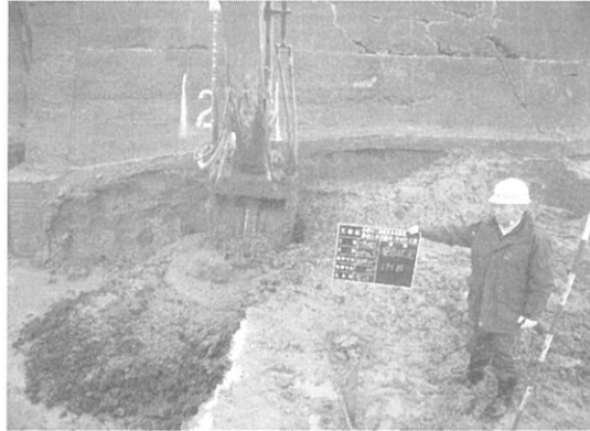
図-13 地盤改良工-パワーブレンダー工法、攪拌混合状況②
