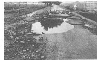
管の破損に伴う漏水により道路が陥没
