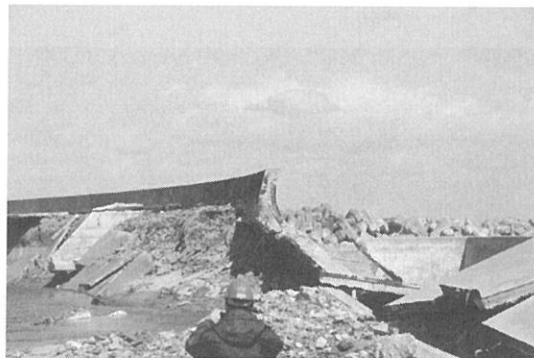
図-16 破堤した海岸堤防
