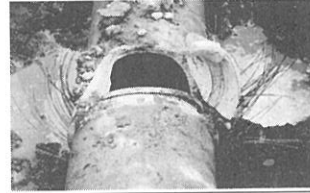
継手部分が破損し水が噴出したパイプライン
