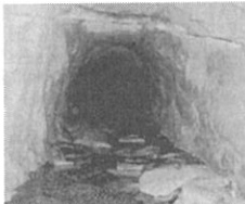
ライニングが崩落した水路トンネル
