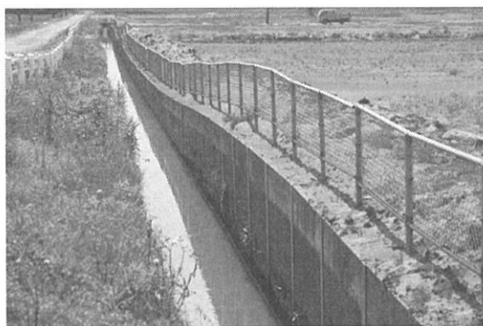
図-19 液状化による水路の浮上・沈下
