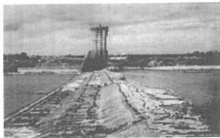
流水による侵食が著しい頭首工
