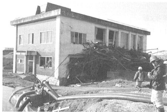
図-17 排水機場の損傷
