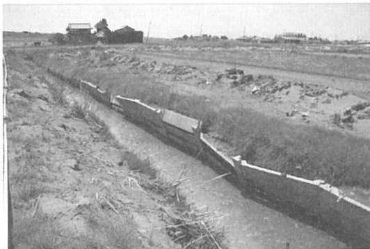
図-18 液状化による水路壁の倒壊
