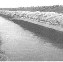
倒壊した矢板（五所川原市）
