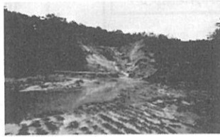
堤体が決壊し漏水したため池
