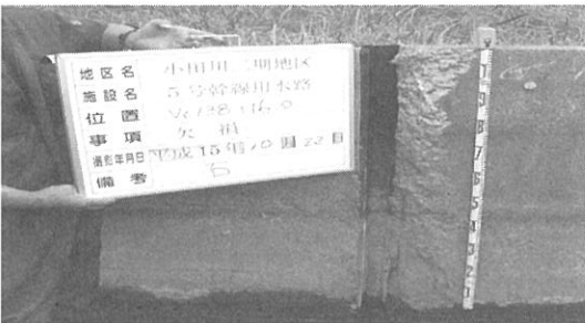
図-18 表面被覆工-第5号幹線用水路剝離・欠損(着手前)
