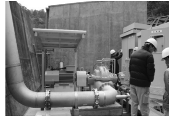
写真-4 志河川ダム小水力発電施設
