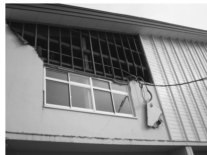
写真-2 2011年3月11日、震災直後の本校体育館
