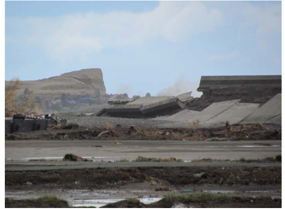
図 11 決壊した堤防（4 月 20 日）
