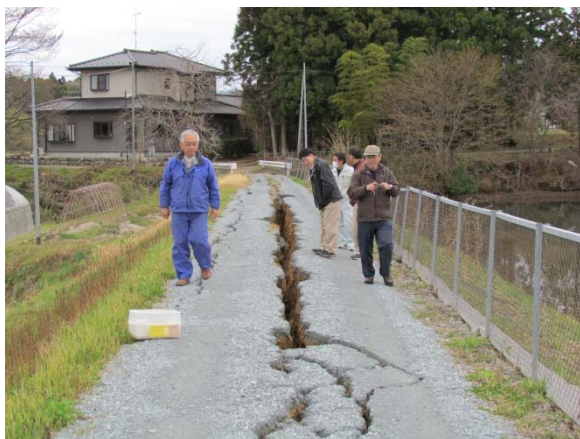
図 23 ため池の地震被害
