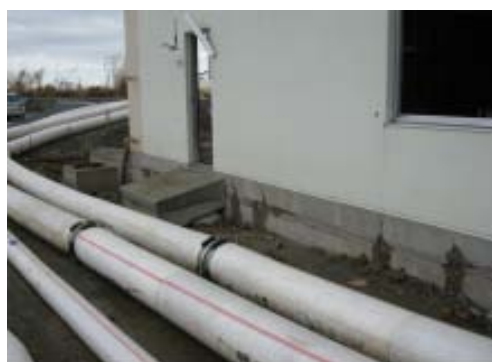
図 25 排水機場の抜け上がり
