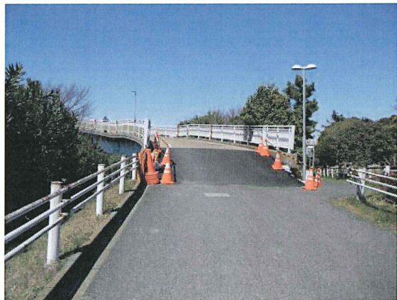
湾岸線浦安 IC 横の歩道橋と取付道路に段差 ができていた。
