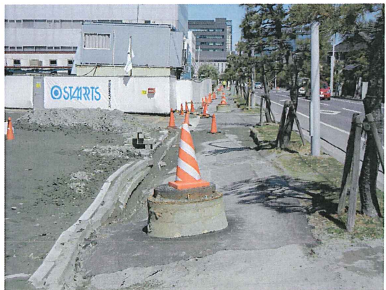
液状化で浮き上がった下水マンホールと吹き上がった砂（日の出、約200mの間で6基ほど）
