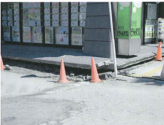
液状化で地盤が30cmほど下がったビル（入船4丁目）
