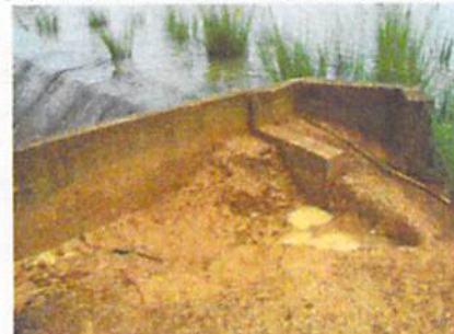
写真2: 魚類の遡上を障害し、洪水処理能力にも問題があるダム3の洪水吐
