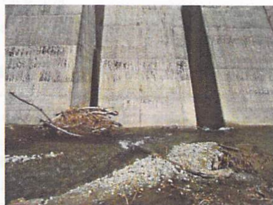
写真2 堤体背面の流木
