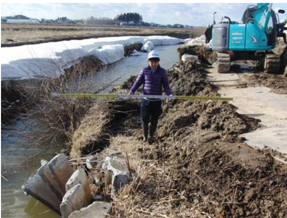
土淵堰用水路右岸の土砂崩落
