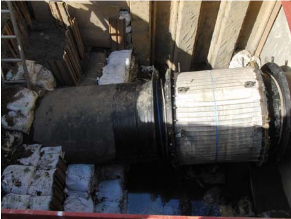
芦野幹線用水路水路第5号分土工（パイプライン） （可とう管の破損：津軽北部地区）
