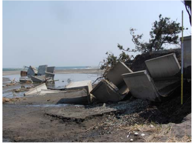
淋代中央排水路の海岸出口部の損壊・流出
