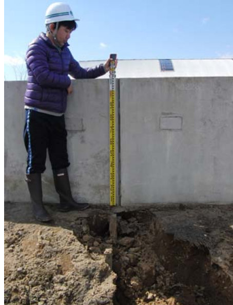
東俣1号幹線用水の継目の目地の破損 （置き樋構造による二次製品施工）
