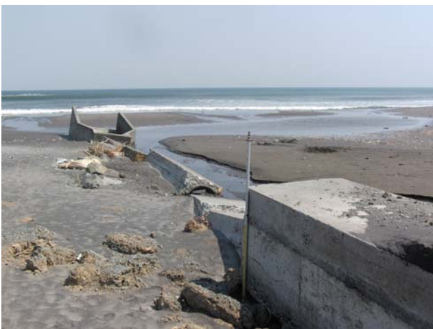
淋代南排水路の海岸出口部の損壊・流出
