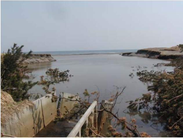
六川目北排水路の海岸出口部の損壊・流出
