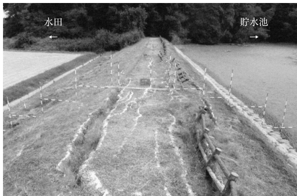
写真-2 東日本大震災による A ため池の堤体崩壊
