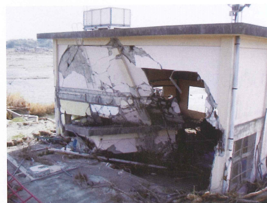
写真-4 被災した排水機場② (南相馬市)
