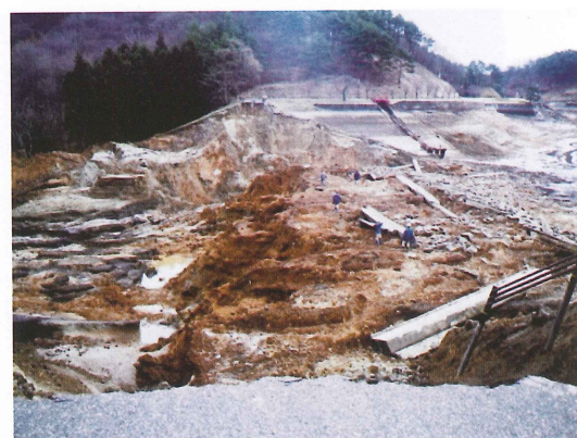
写真-6 決壊した農業用ダム (須賀川市)
