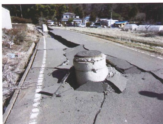
写真-7 被災した集落排水管路 (泉崎村)
