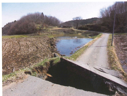
写真-5 被災した断層上の農道 (いわき市)
