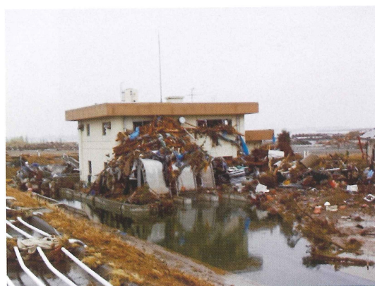
写真-3 被災した排水機場① (相馬市)
