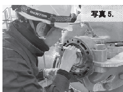
揚水ポンプ軸受より採取(グリース)
