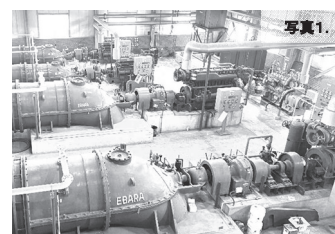
排水機場の横軸斜流ポンプ
