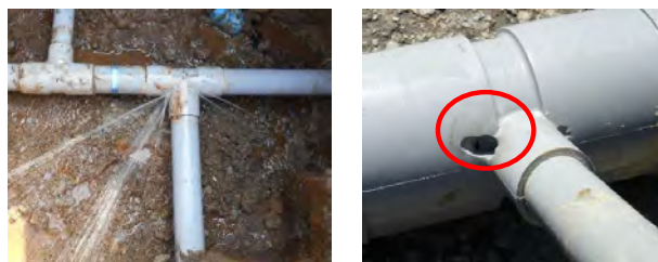
経年劣化や地震、地盤沈下などによる割れ・破損事例
