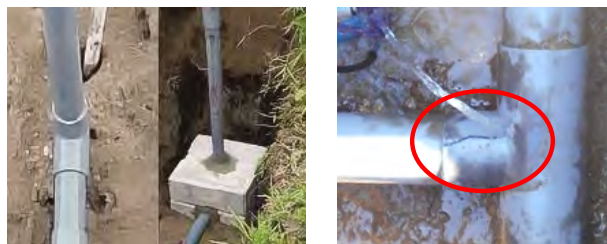
スラストブロック沈下による接合部付近の割れ・破損
