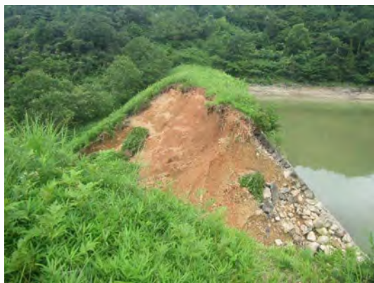
ため池豪雨被害（大田池、岡山県）
