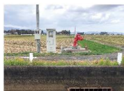
自動運転化したゲート
