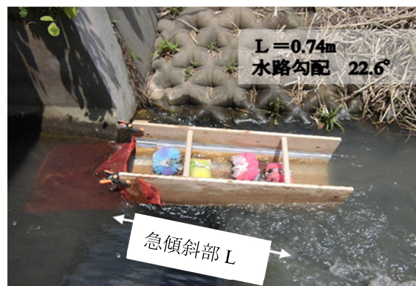
Fig. 2 排水路急傾斜部に設置した可搬魚道
