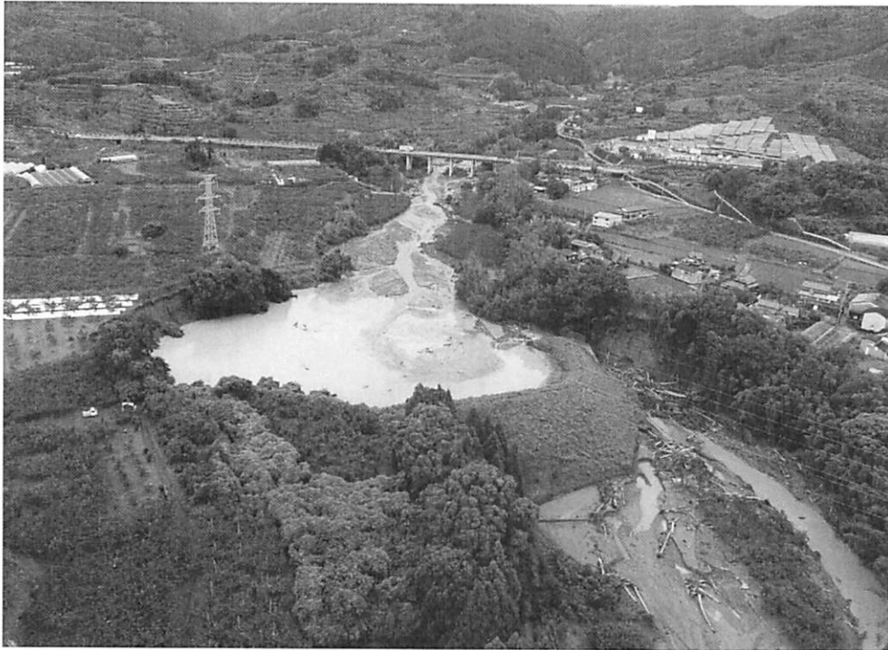
鎌塚ため池（洪水吐崩壊・土砂流入等）
