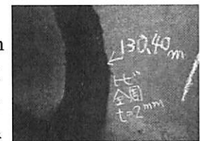
図7 サイホンひび割れ
