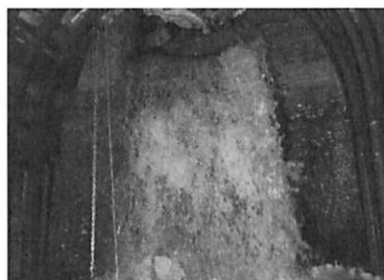
写真-2 大量出水状況
