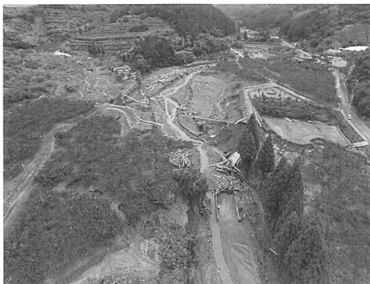
山の神ため池（越流破壊）
