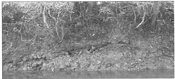
写真1 地山の地層亀裂
