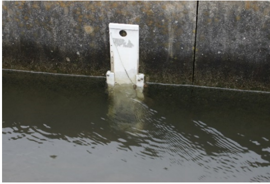
写真-2 既存の用水位調節器
