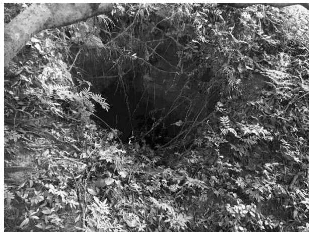
写真1 陥没箇所（撮影：2020年7月11日）
