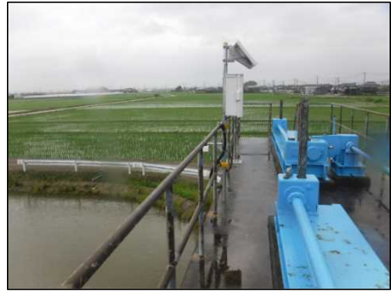
写真 7 : 電源及び伝達装置
