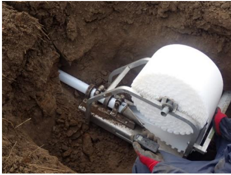
写真-4 パイパー(パイプ成形機)
