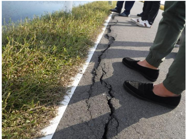
Fig1 農道路肩に発生したクラック
