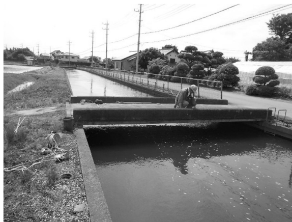
図3 用水路の橋(桁下の空間が狭い)
