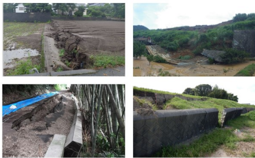
躯体が転倒している
