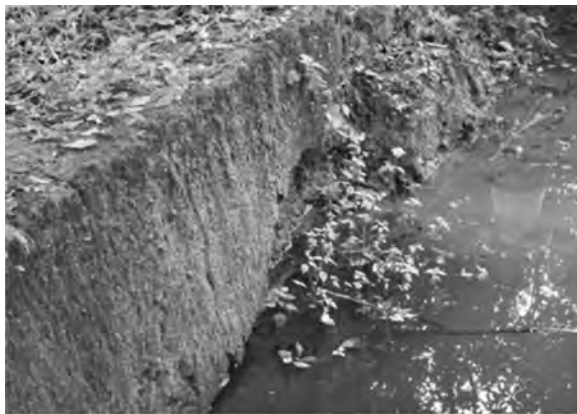
写真-1 崩壊が始まったむき出しの鉛直コア
