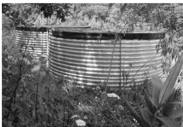
写真-3 使用できなくなった鋼製ため池
