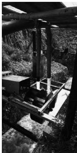
写真-6 水車発電装置の最終的な稼働状況
