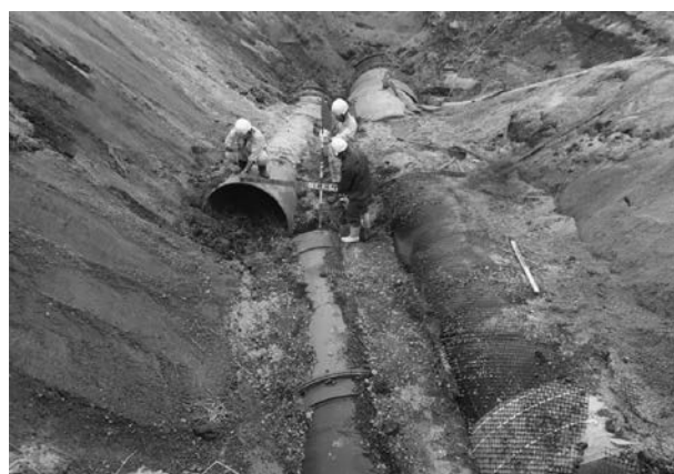
写真-8 屈曲部前後の管の離脱（並列配管区間、右が厚幌導水路、左の離脱した管は支線）
