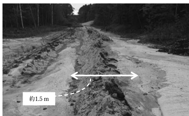
写真-7 厚幌導水路埋設部の地表面の浮上
