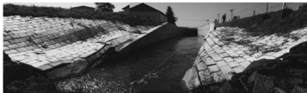
写真-10 連節ブロックの沈下やはらみ出し
