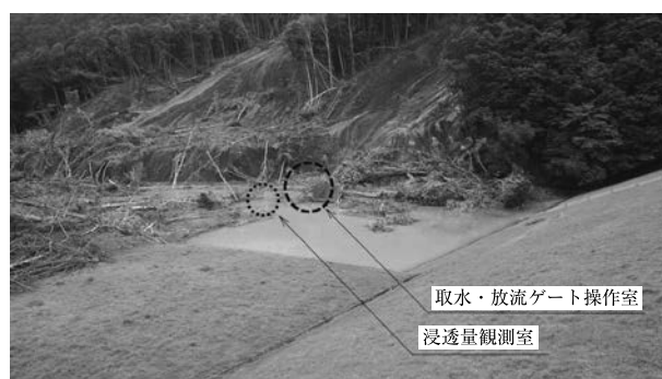
写真-2 埋没した取水・放流ゲート操作室と浸透量観測室
