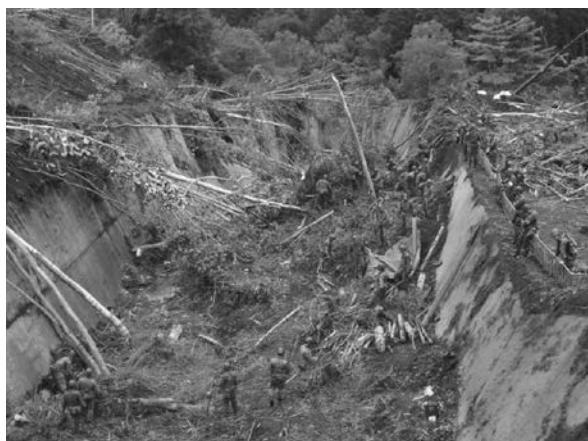
写真-3 洪水吐の土砂堆積状況および倒木撤去作業
