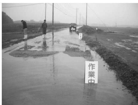
写真-1 県営水路（φ250 mm）破損に伴う被害状況
