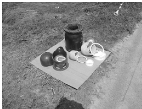
写真-2 空気弁案内の破損状況
