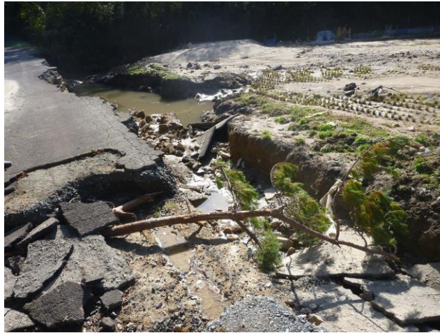
写真16 道路と農地の崩壊
