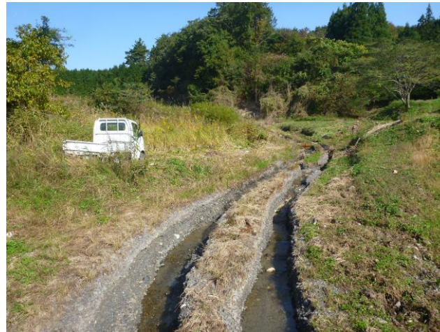
写真20 あぜ道が洗掘された農道
