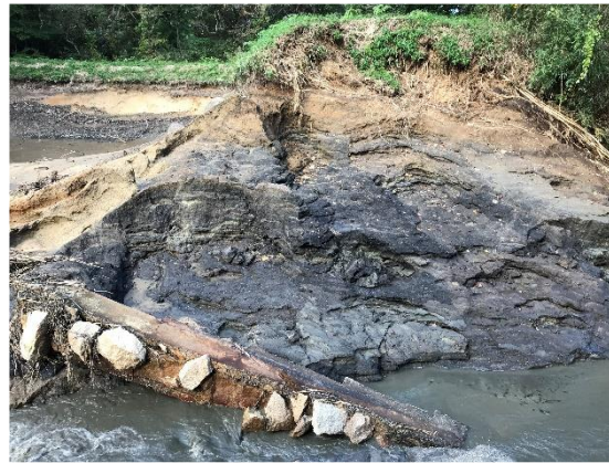
写真3 逆川下ため池の決壊面 および底樋
