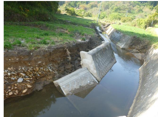
写真21 水路の崩壊と農地浸食
