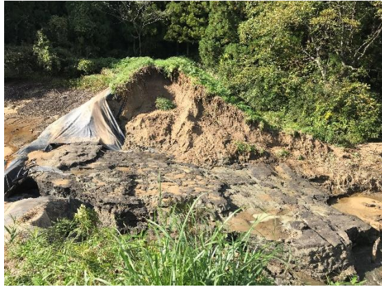
写真1 逆川上ため池の決壊断面
