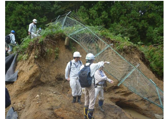
写真5 長柴山ため池の決壊断面
