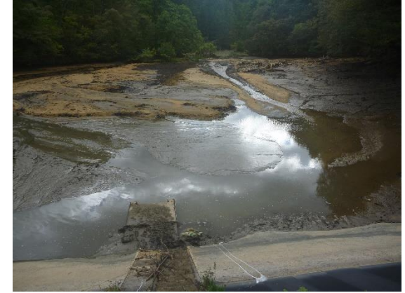
写真6 長柴山ため池の貯水全量流出
