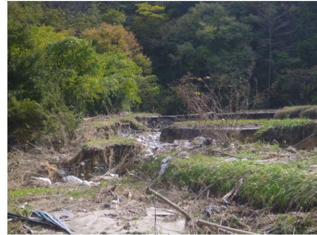
写真18 崩壊した棚田
