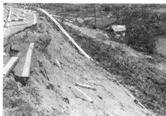
写真-2 国道のガードレールとノリ肩部の崩壊
