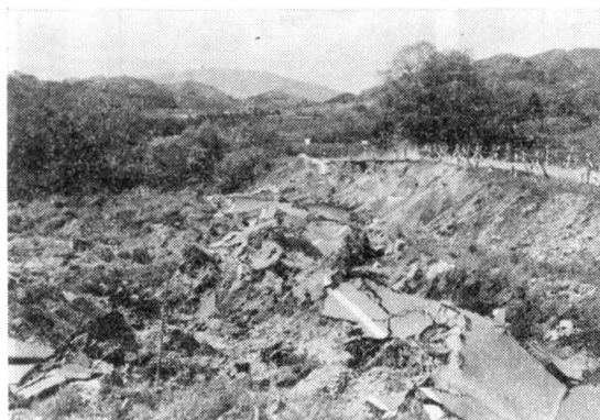
写真-1 国道がほとんど全部（2車線とも）崩壊
