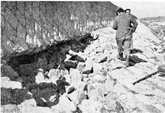
写真—12 乙川開拓前面石張りの破壊状況
