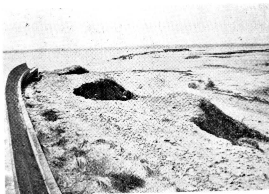
写真-16 碧南干拓決壊口の遠望および堤体盛土の侵食状況
