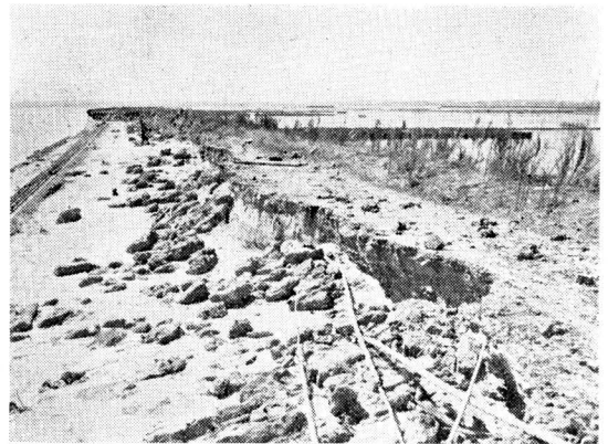
写真-18 碧南干拓河川堤盛土の侵食状況
