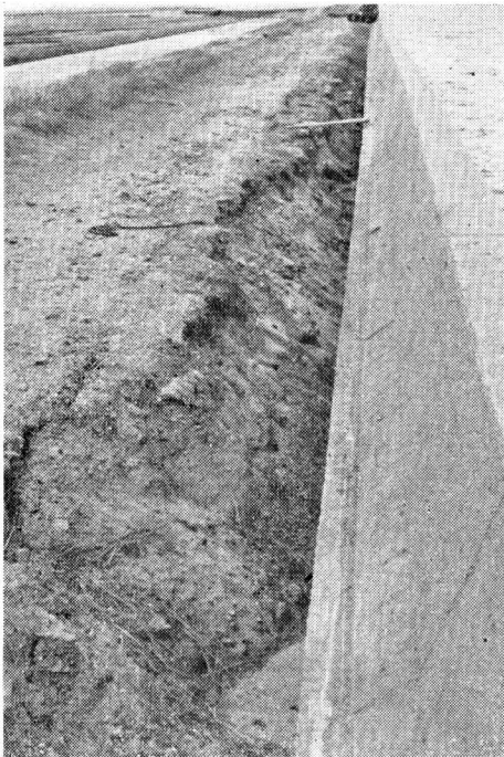
写真-17 碧南干拓盛土の流失状況
