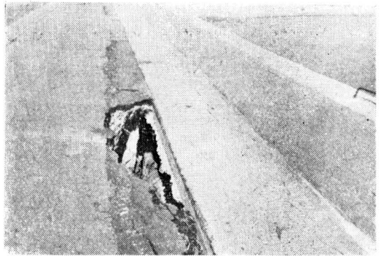
写真—14 乙川開拓テンバ舗装の陥没カ所
