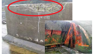
頭首工導流壁の欠損、ゲートの腐食・水密ゴムの劣化
