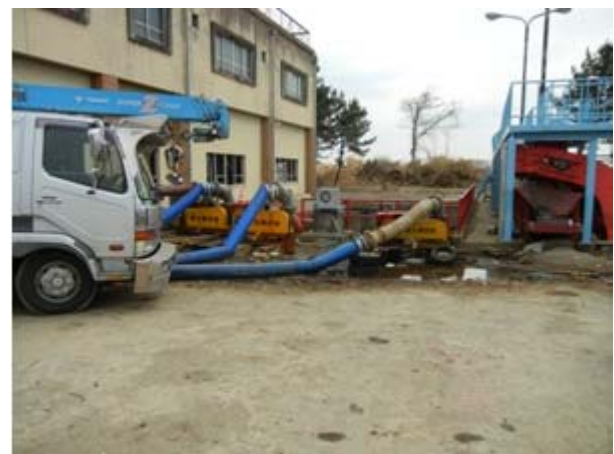
写真11 稼働している災害応急ポンプ
