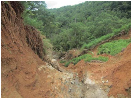
3. 大田池（岡山県・浅口市） 堤体決壊部（決壊部から下流へ望む）
