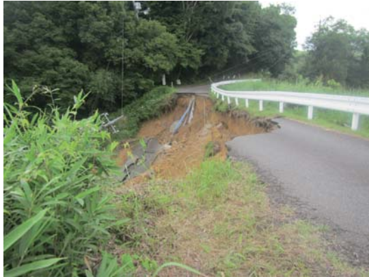
1. 冠光寺池（岡山県・岡山市） 堤体崩壊部（堤体左岸より望む）
