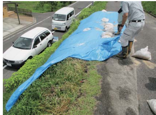
4. 二子池（岡山県・浅口市） 堤体直下市道の浅いすべり
