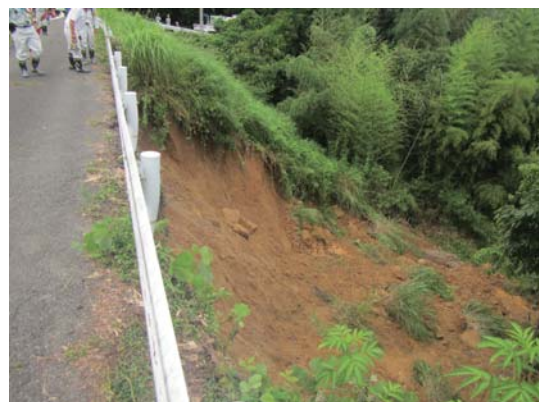
5. 山地下池（岡山県・倉敷市） 堤体崩壊部（堤体天端右岸側より望む）
