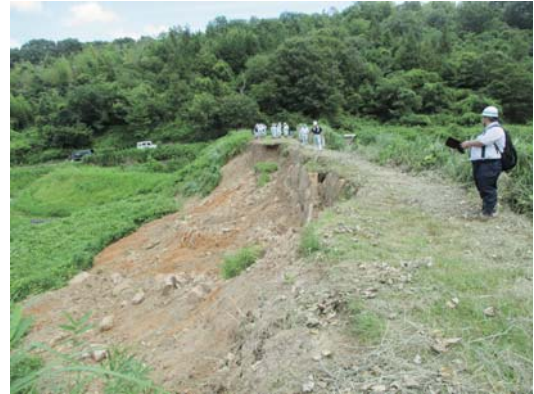
2. 江田池（岡山県・岡山市） 堤体崩壊部（堤体左岸より望む）
