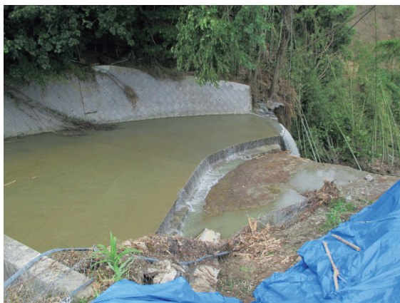
4. 崩落した洪水吐水路（洪水吐右岸側から撮影）
