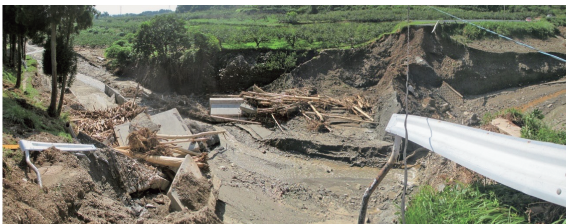
8. 山の神ため池の決壊した堤体部（右岸アバットから堤体決壊部を望む）
