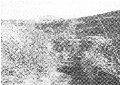
写真-4 火山性地震による排水路の倒壊と法面の崩壊（洞爺村成香地区）
