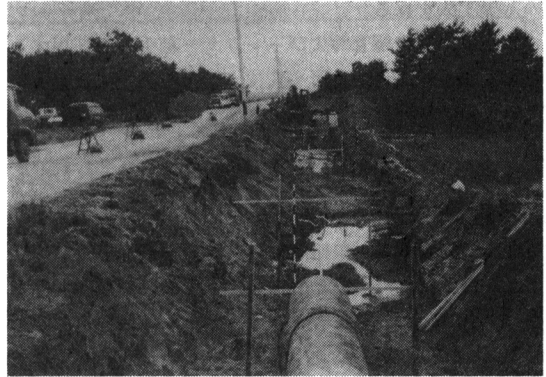
写真-2 南部幹線用水路と中央幹線道路の被災（用水路が右側に1.4m移動し、道路が沈下した盛土区間）
