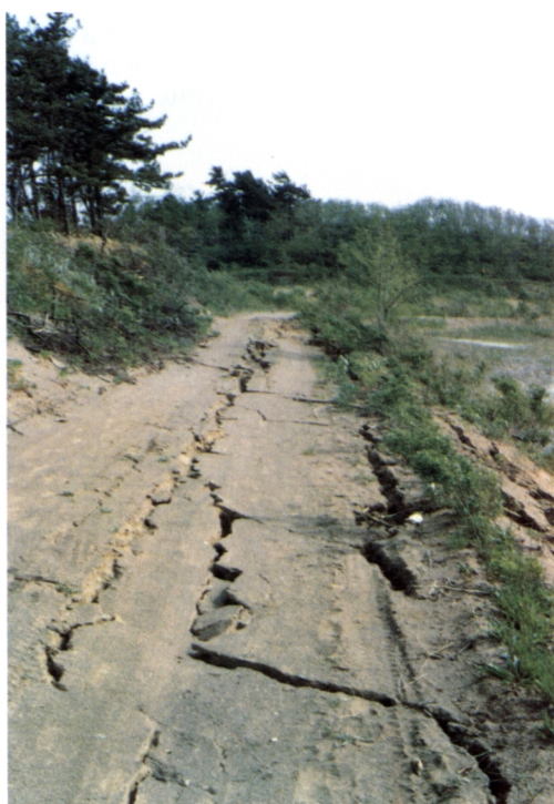
道路の破損（写真提供：西土地改良事務所）
