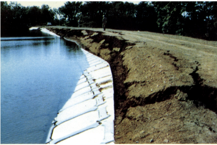
堤体の亀裂と張ブロックの滑落（青森県深浦町，写真提供：西土地改良事務所）
