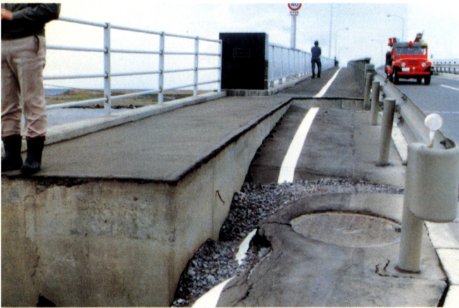
岩木川十三橋取付部の沈下（青森県市浦村）
