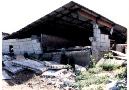
豚舎の倒壊（青森県木造町）
