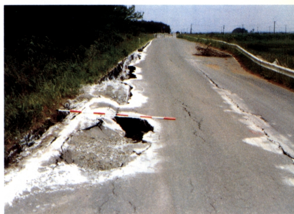
路肩の陥没（青森県木造町）
