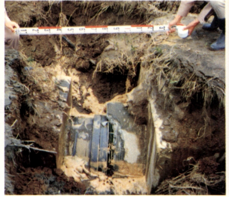
屏風山，中央幹線水路の破損（写真提供：屏風山開拓事業所）
