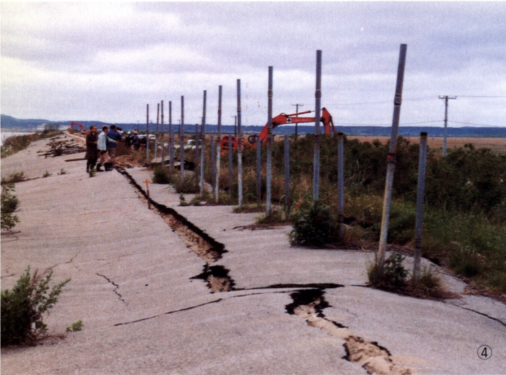
↑ 正面堤防の被災
