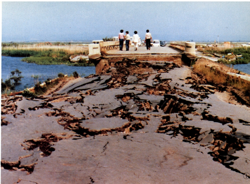
道路の橋梁取付部の 沈下(五明光橋付近)
