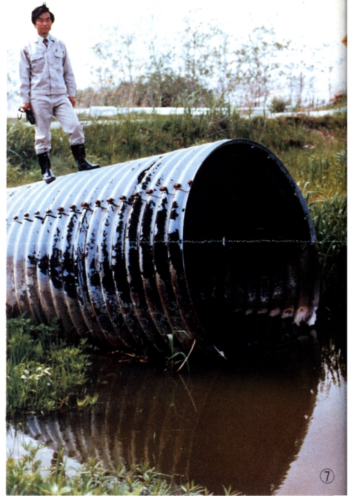
道路横断暗渠（コルゲートパイプ）の被災↑
