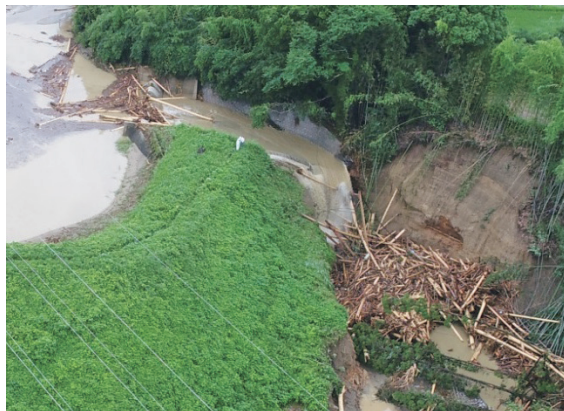
2. 洪水吐左岸側下流の地山が崩壊
