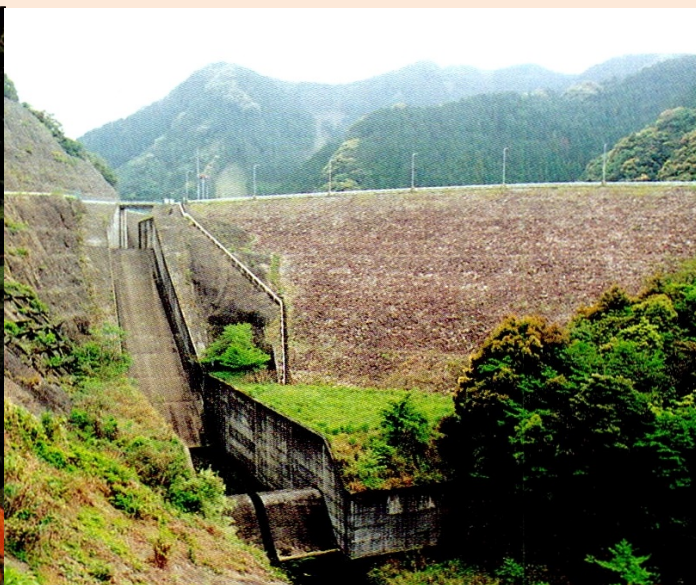
御手洗ダム（1997年薩摩地方地震被災後）
