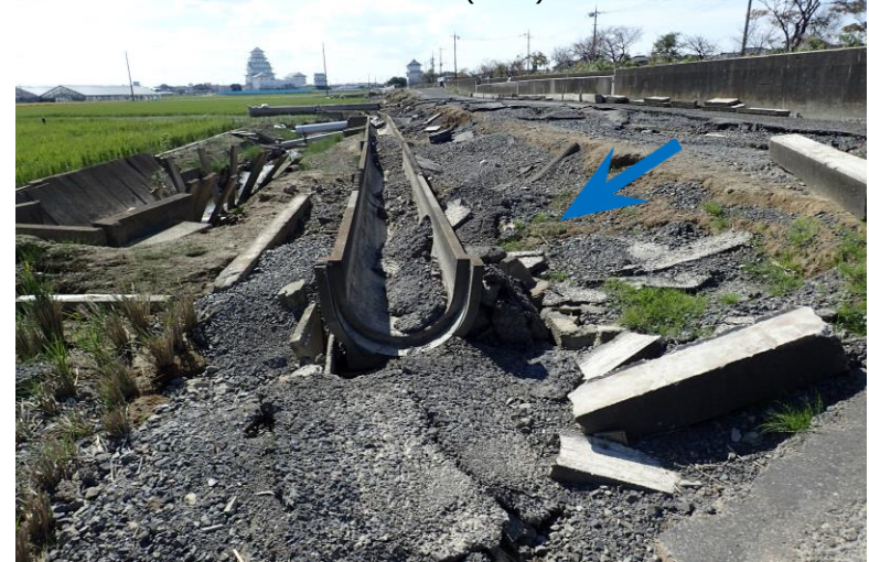
堤防決壊氾濫に伴う用水路の破壊(堤内)
