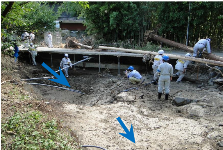
頭首工右岸堤越流に伴う管理用道路盤洗掘(堤内)
