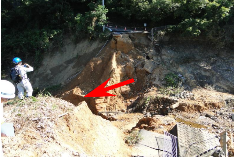
台風豪雨に伴うため池堤体の崩壊
