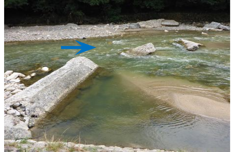
堰 (頭首工)の破壊(堤外)
