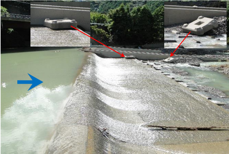
頭首工上流河床ブロックの流出(堤外)
