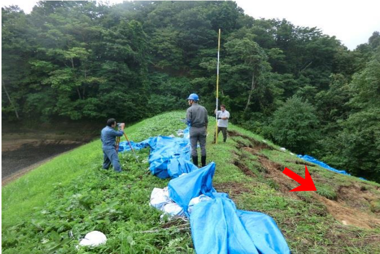
台風豪雨に伴うため池堤体下流法面の崩壊
