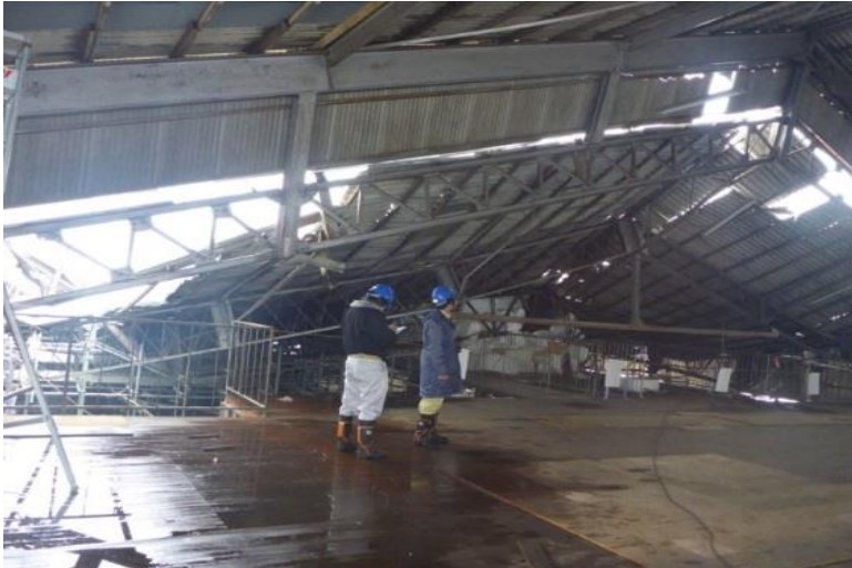
降雪に伴う集出荷施設の屋根倒壊
