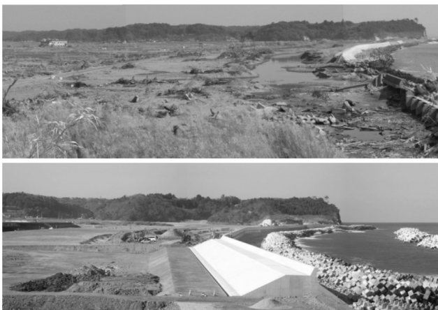
写真-6 上：被災直後，下：復旧中の海岸堤防 (南相馬市・北老海岸)
