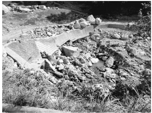
写真-9 土石流による農道路面の破壊（熊野市金山町金山神社付近）
