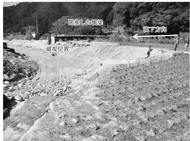
写真-2 木材による橋梁閉塞により、氾濫した洪水により侵食された水田(熊野市飛鳥町神山地区)
