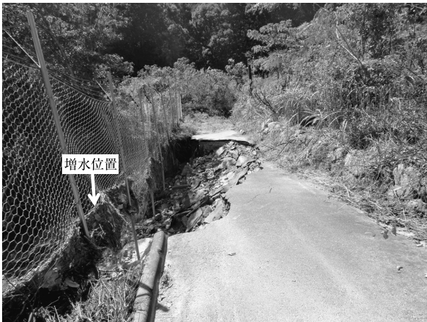
写真-11 溪流脇の農道路床の侵食（紀宝町提供、紀宝町小畑地区）
