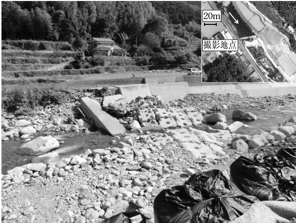
写真-5 被災し流失した頭首工（熊野市井戸町井戸浄水場付近）
