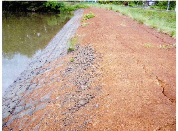
(5)野中ため池（岩手県奥州市）—地震動で天端部にクラックが生じ、上流保護ブロックもずり落ちている—（写真提供：胆沢平野土地改良区）
