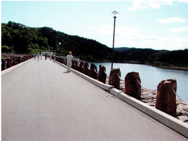
(4)小田ダム（宮城県栗原市）の天端ブロックに生じた変状
