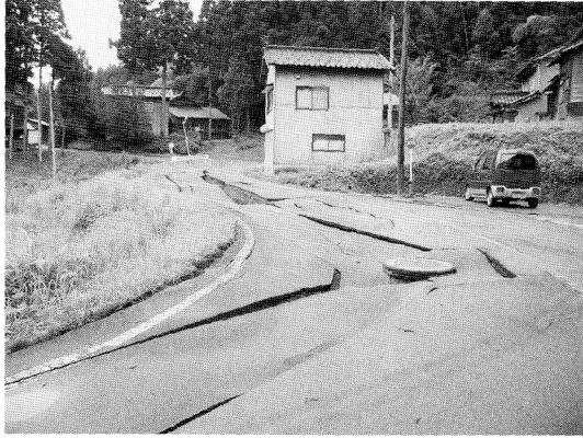
写真-1 埋設管路上の路面陥没状況
