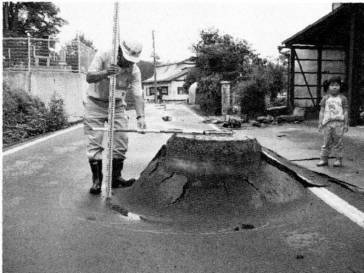
写真-2 マンホール浮上り状況
