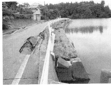
(b) 護岸の破損 (東大池, 柏崎市西山町和田)
