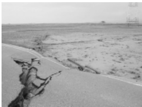
写真6 連続する段差・亀裂 段差・亀裂は農道を横断し, 鉄塔の方向に直角に曲がる
