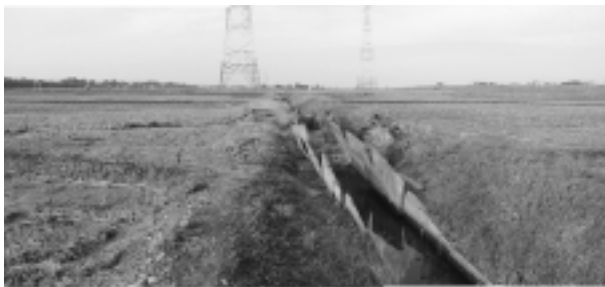
写真7 段差・亀裂と排水路との交差点 水路底は最大で約1m上昇している
