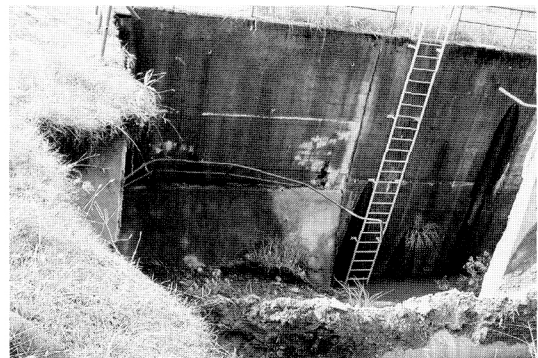
写真-2 洪水吐被災状況 (左岸より右岸を望む)
