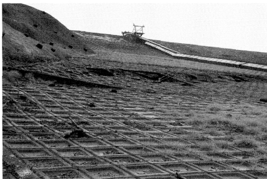
写真-1 堤体被災状況 (左岸部全景)
