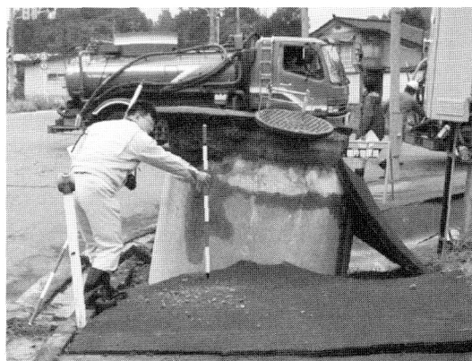
写真-3 浮上した集排水穴 (柏崎市)
