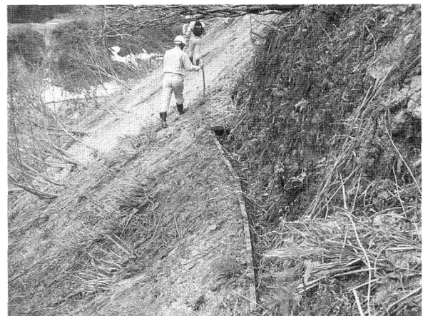
写真-1 山腹水路の被害
