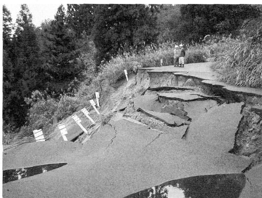
写真-1 広域農道の被災 (魚沼市)
