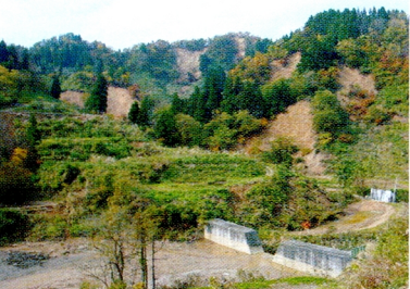
10. 崩落は山間地で随所に見られる（小千谷市岩間周辺）
