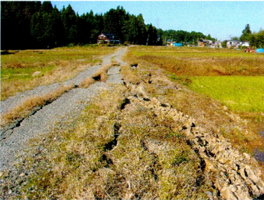
4. 道路の裏面にも亀裂が入り広い範囲ですべりが認められる、傾斜1/40程度（小千谷市両新田周辺）
