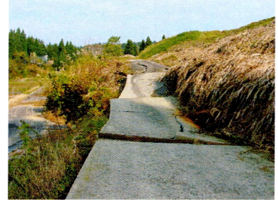
3. コンクリートの舗装が波打ち、人の進入さえ拒んでいる（川口町武道窪周辺）
