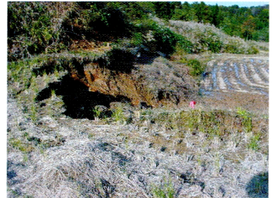
6. 圃場の畦畔の崩壊 地震による亀裂・崩壊に加えて水の介在があったと思われる、山間地で、傾斜は1/10以上（小千谷市逃入周辺）
