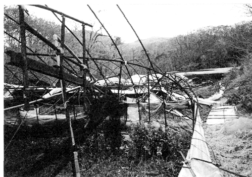
写真-3 降灰による重みと二酸化硫黄ガスによるパイプの錆で折れ曲がったビニルハウス
