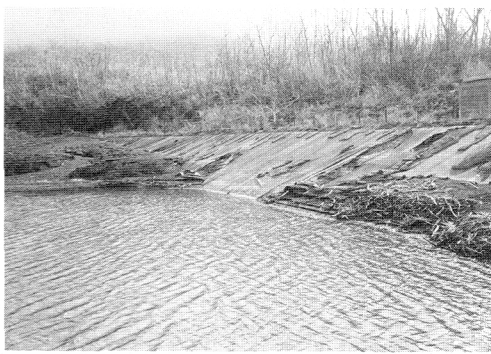
写真-4 笠地貯水池法面への火山礫降下によるゴムシートの破損状況
